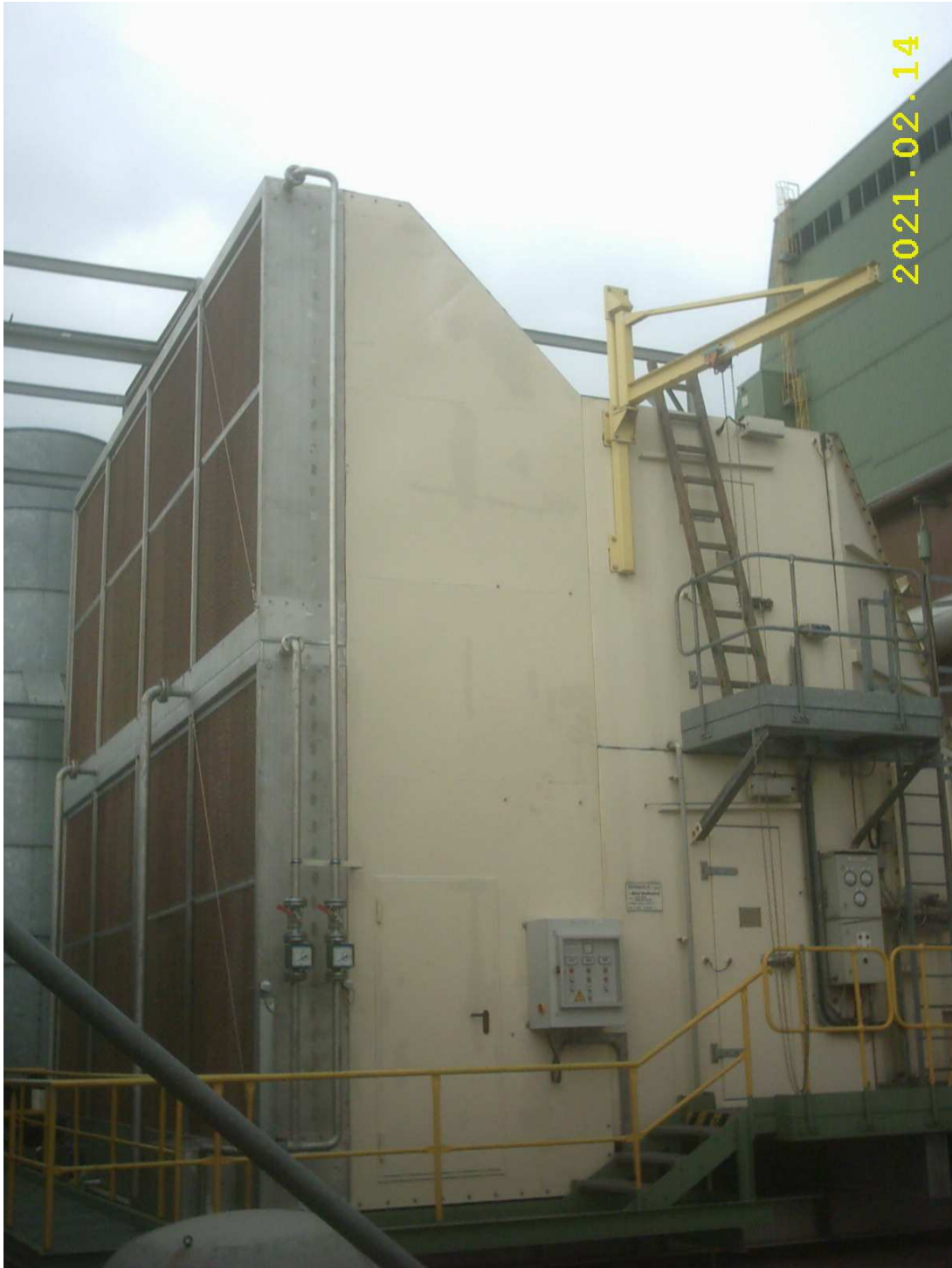
Energetica Kladno/ Czech Republic
